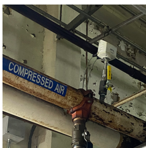
S430 Durchflussmesser für nasse Druckluft (Einstecktyp) Einbauort.
