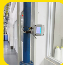
S401 Durchflussmesser in Hauptdruckluftleitung montiert
